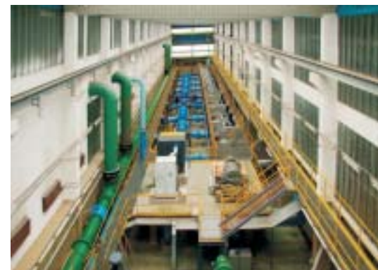
Zakład Produkcji Wody - pompownia
