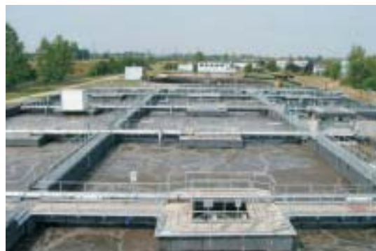
Część biologiczna Zakładu Oczyszczania Ścieków przy ul. Spokojnej
